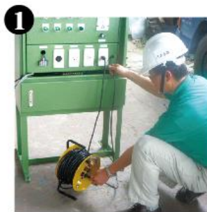
1. 接上電源並將模擬負載線接入被测延長線
